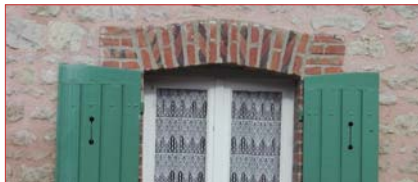
Jour de ventilation.
