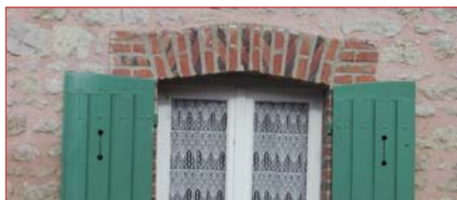
Jour de ventilation.
