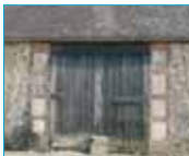
Tuiles en terre cuite, silex, bauge, briques en terre cuite, hêtre pour la porte de la grange. Saint-Jean de Rebervilliers.
