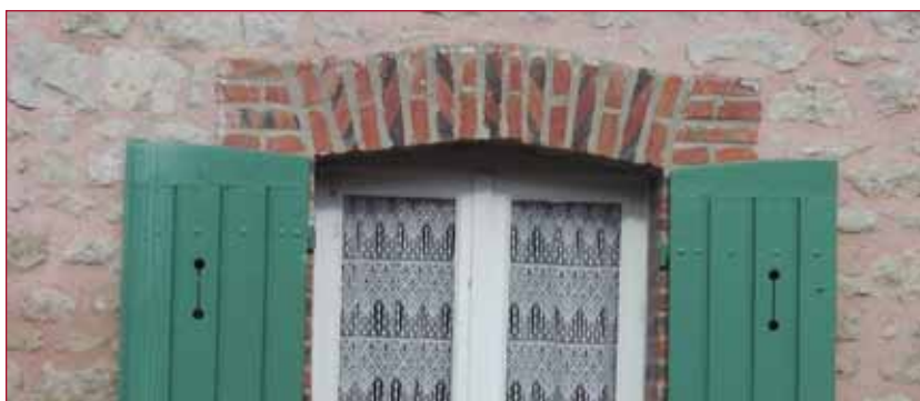
Jour de ventilation.
