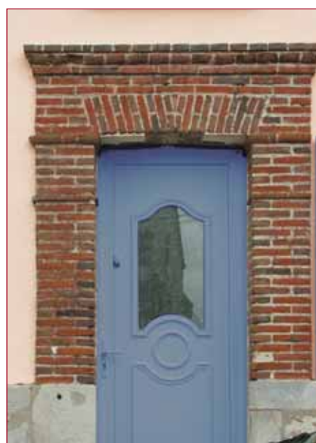
Exemple satisfaisant de l'entretien d'une maçonnerie en brique. Les couleurs et textures des nouveaux joints ou des briques remplacées sont identiques aux anciennes.
