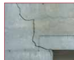
Enduit* ciment sur une maçonnerie ancienne : fissurations
