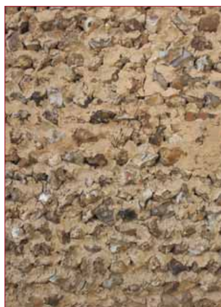
Maçonnerie en silex dégarnie.
